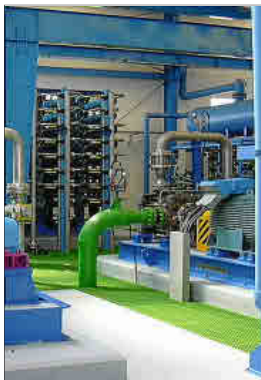
Interior de la desaladora de Palma.
